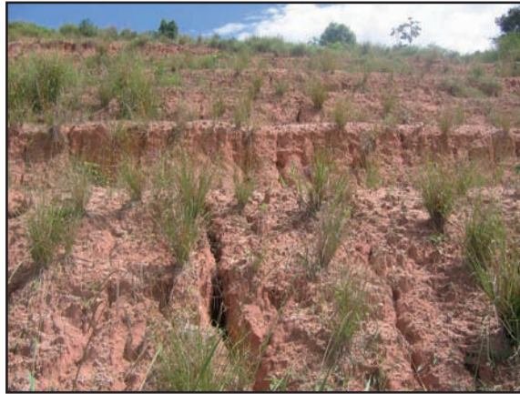
Exemple d'une érosion hydrique sur un talus à forte pente qui n'a pas pu être stoppée malgré la plantation de vetiver
