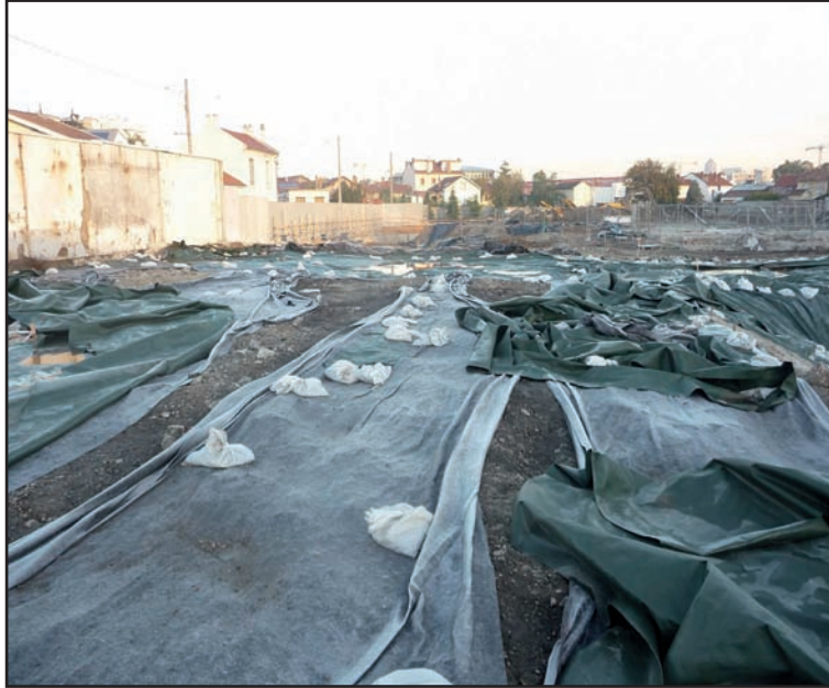
État des bâches de couvertures après intempéries et rafales de vent
